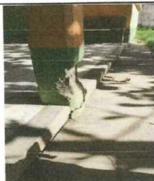
Foto 6: Se puede observar la columna portante en mal estado.
