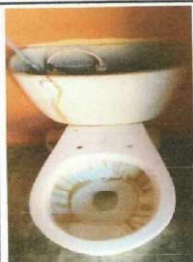
Foto 3: Se puede observar el deterioro de los inodoros portantes del modulo 2.
