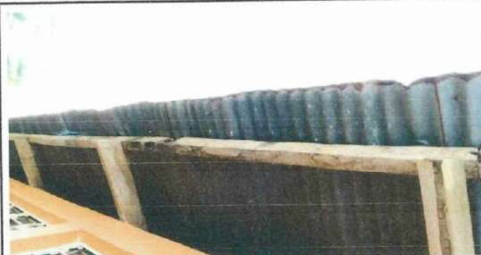
Foto 2: Se puede observar el deterioro de la estructura portante del modulo 1.
