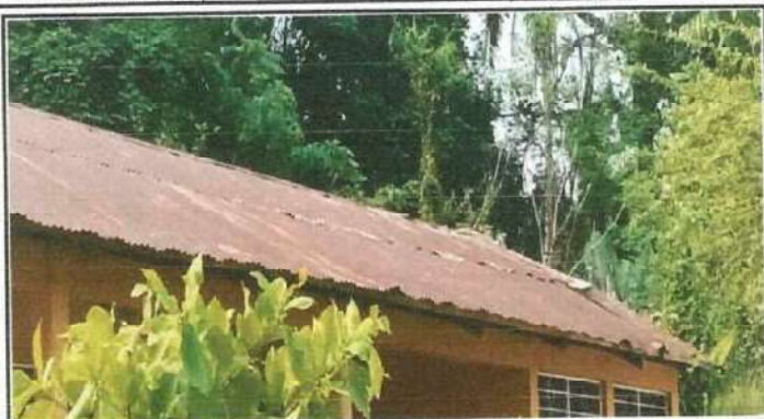
Foto 1: Se puede observar las láminas portantes en mal estado del modulo 1
