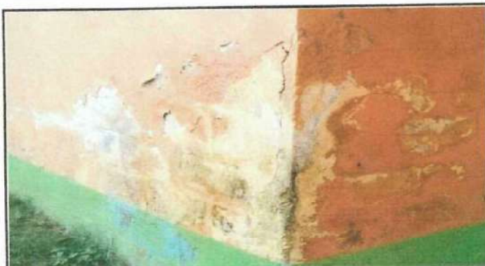
Foto 4: Se puede observar el desprendimiento en pintura en las paredes.
